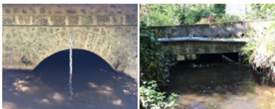
Succession de ponts sous-dimensionnés dans le centre-bourg
