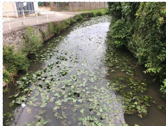
Arrachage ou coupe à réaliser sur une partie pour redessiner un chenal d'écoulement
